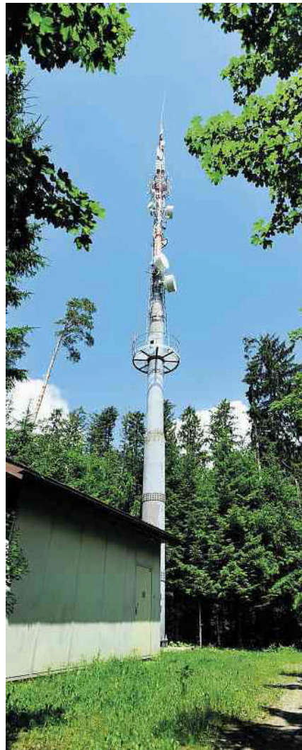
Die Antenne auf dem Sirnachberg soll durch eine höhere mit erweiterter Sendeleistung ersetzt werden. Bild: Mario Testa
